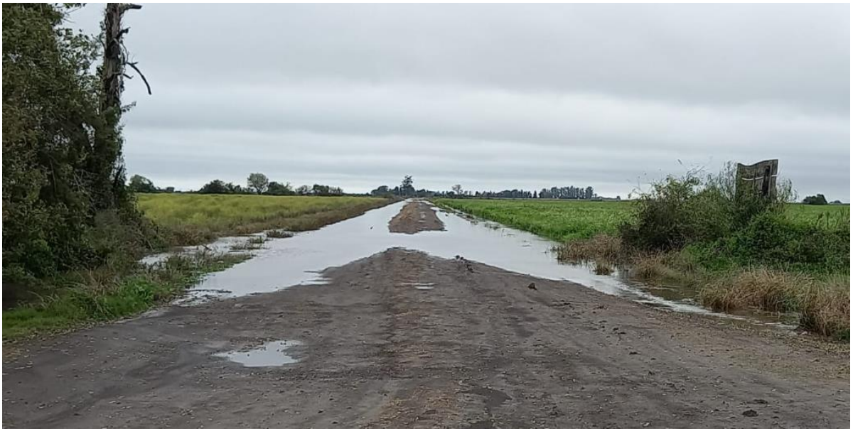
◆ Camino de tierra, anegado, cunetas desbordadas, intransitable, en el sureste del departamento Vera.
