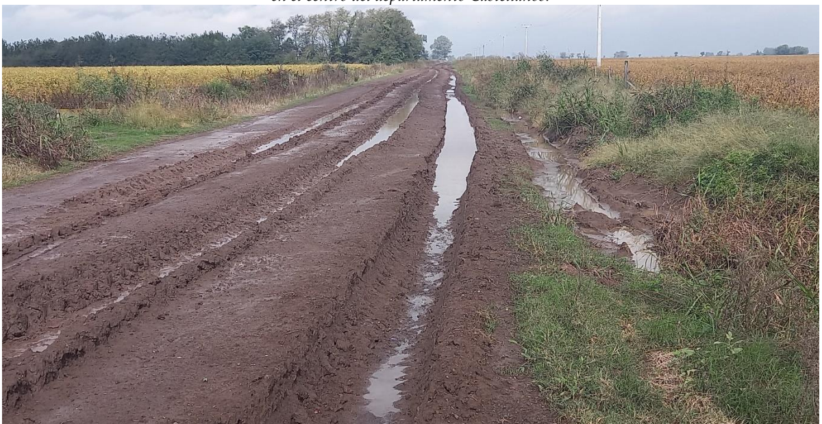
◆ Vía de comunicación de tierra, sin red de drenaje, totalmente deteriorada, en el centro sur del departamento Las Colonias.
